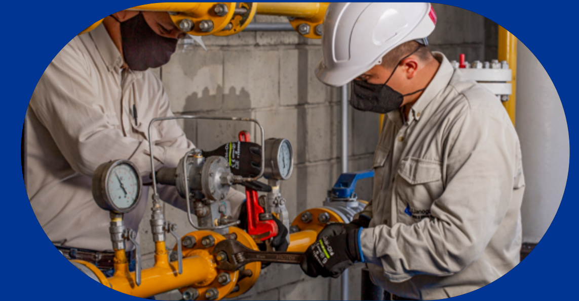
Suministro de gas (INDUSTRIAS Y EDS)
